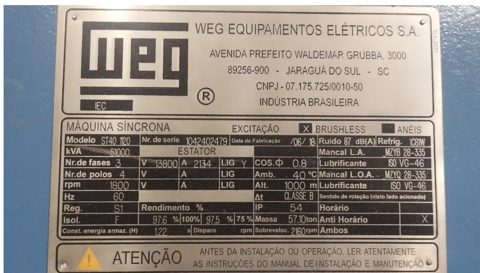
Alternator/ Generator nº 3
